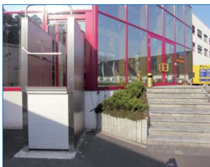
Lift cu platformă la palierul superior asigurând accesul în spațiile comerciale.
